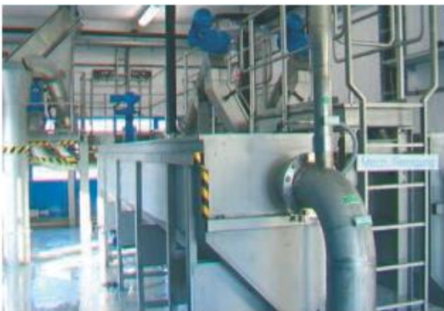
Ant žemės sumontuota atsarginė HUBER smėliagaudė Ro 6.
