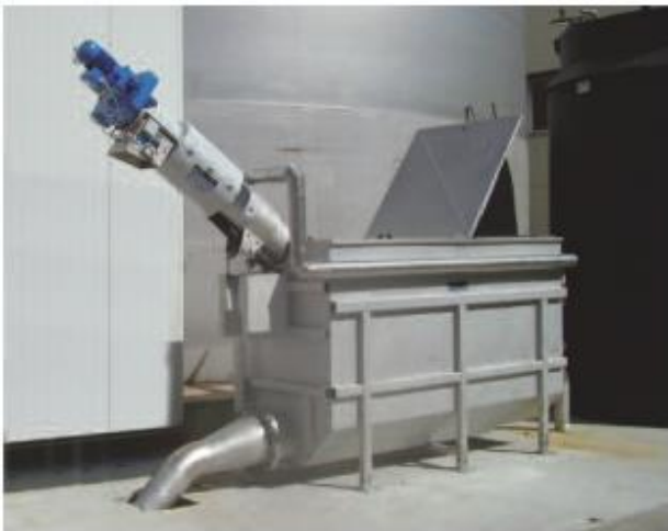
ROTAMAT® būgninis nešmenų šalinimo įrenginys Ro 1 rezervuare.
