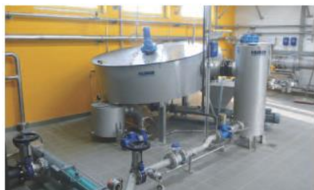
Filtrato laikymo talpa ir purškimo vandens siurblys vandens recirkuliacijai.
